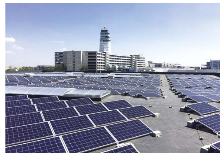
Die E-Speicher sollen auch mit Strom aus unseren Photovoltaikanlagen gespeist werden.
